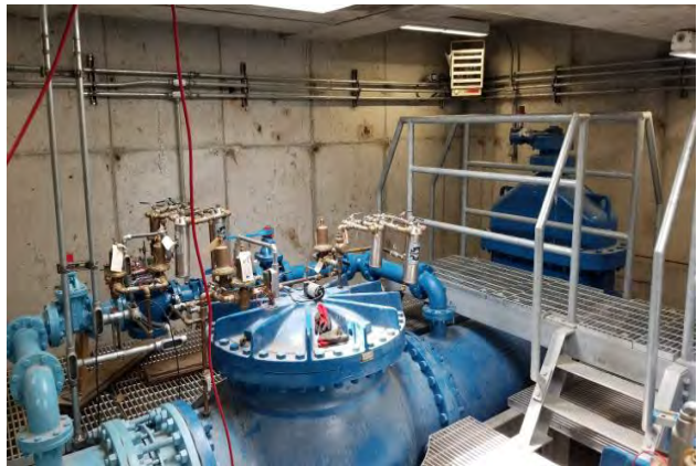
W14 PRV Chamber
